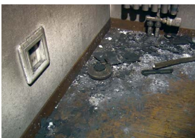
実際の火災後の様子と火災警報器
